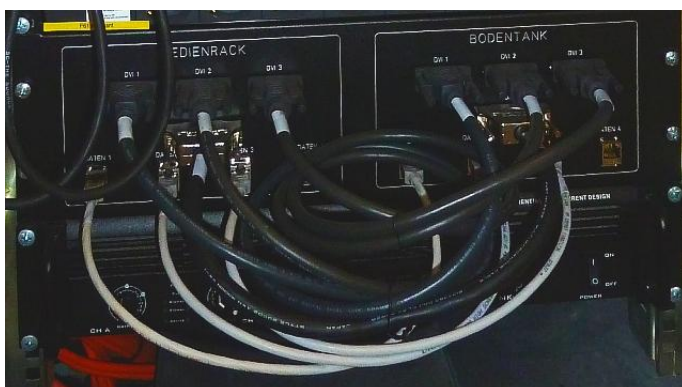
Panel mit Patchkabeln
